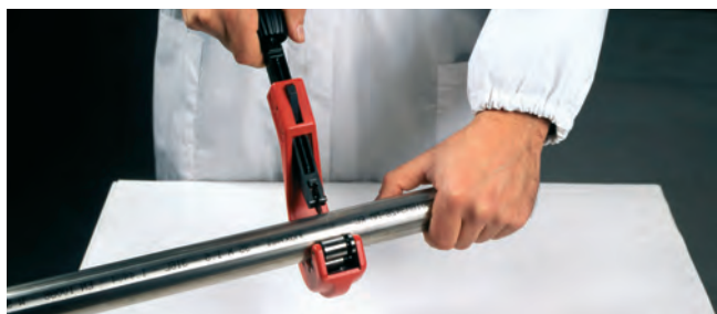
Image 19 – Mise en longueur des tubes
