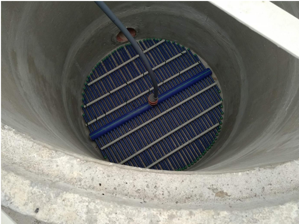
Ryc. 10 Dyfuzor grubopęcherzykowy (rury z wywierconymi otworami) zainstalowany w komorze podnośnika powietrznego
