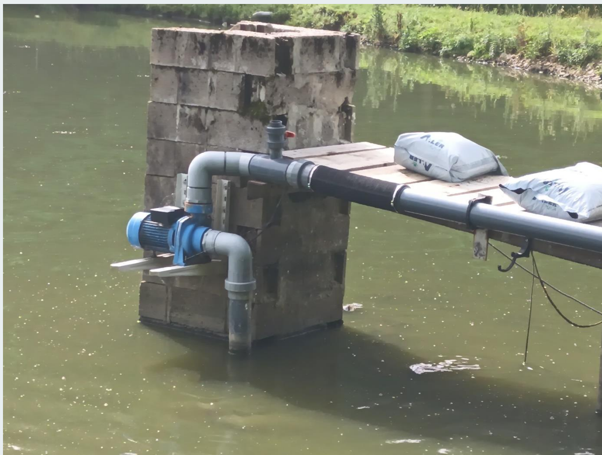
Ryc. 5 Pompa do zasilania systemu TBP.
