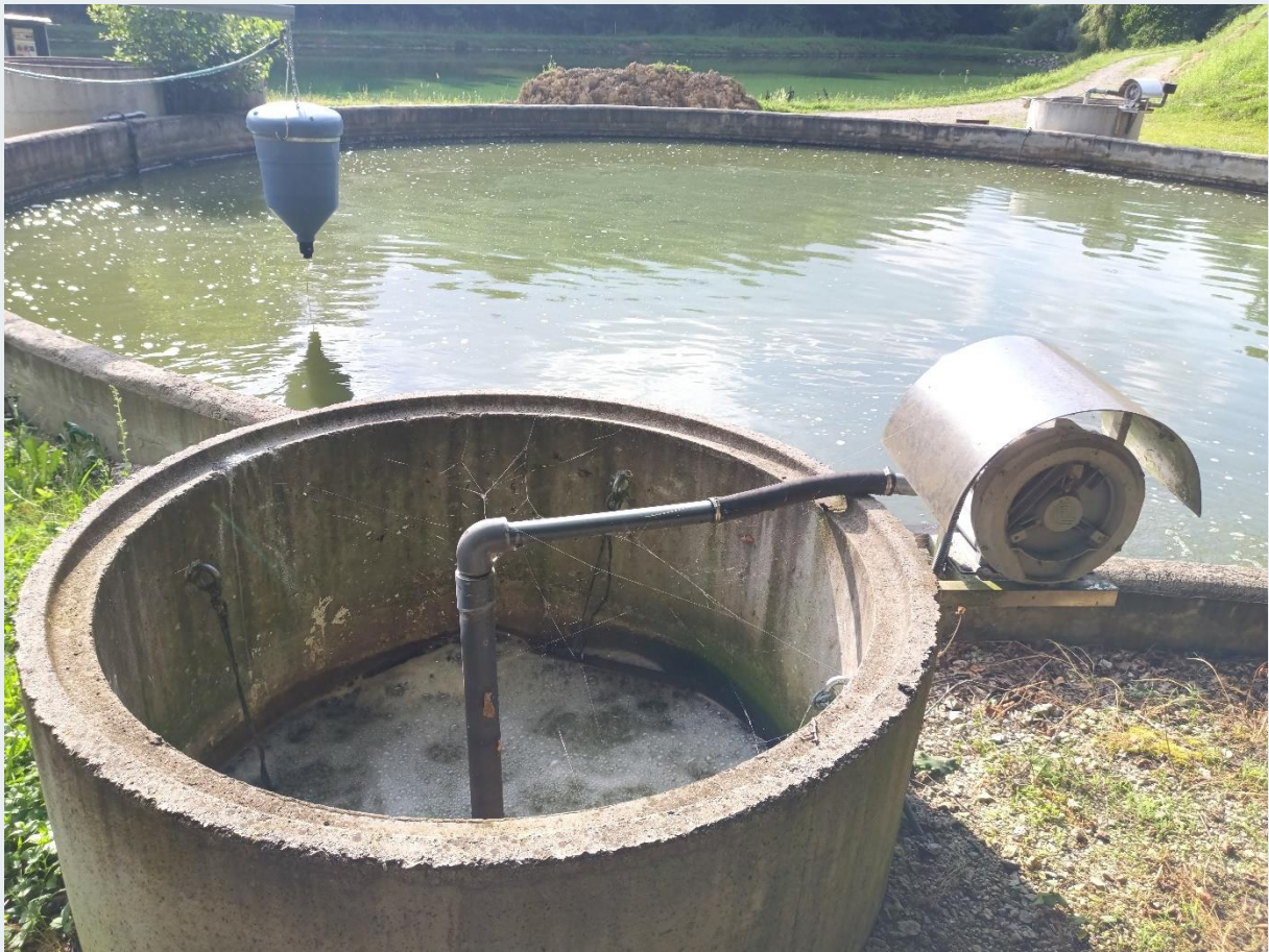
Ryc. 7 Instalacja dmuchaw bocznokanałowych dla każdego podnośnika oddzielnie
