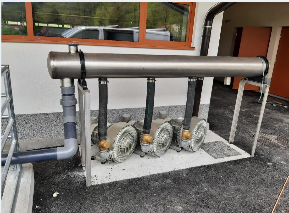
Ryc. 6 Centralna instalacja dmuchaw bocznokanałowych
