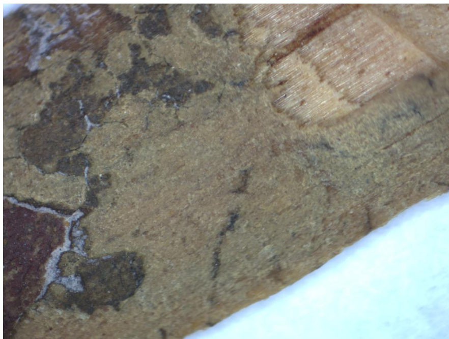
Fot.8. Zbliżenie na fragment pobranej próbki drewna wraz z warstwą farby z nadświetla bramy wejściowej do kamienicy przy ul. Limanowskiego 24 w Stargardzie, lipiec 2025r., zbliżenie na próbkę w powiększeniu, ( fot. L. Piotrowska-Cześnik).
