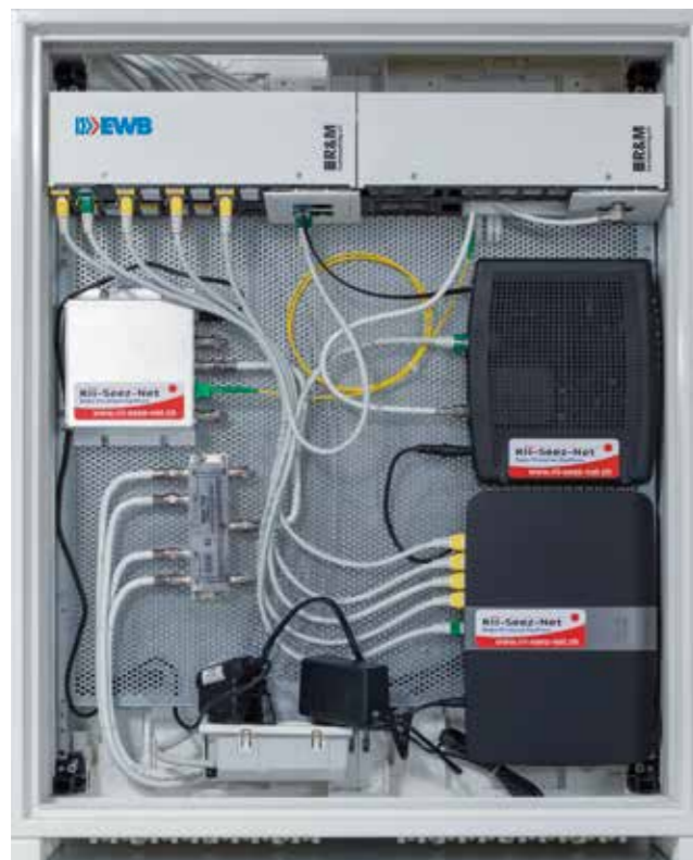
Abbildung 5: Darstellung eines Multimedia-Verteilers, wie ihn das EWB ausrüstet.
