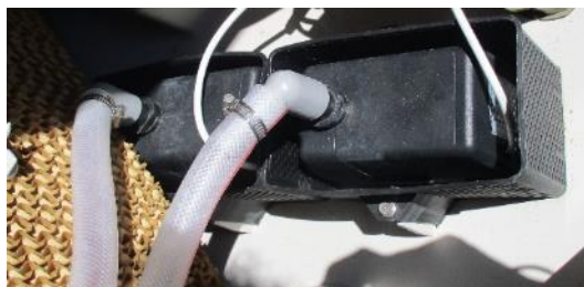
Foto 7 — Sistema di pompaggio per il ricircolo dell'acqua
