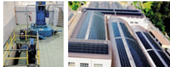
Centrale idroelettrica e impianto fotovoltaico in azienda
