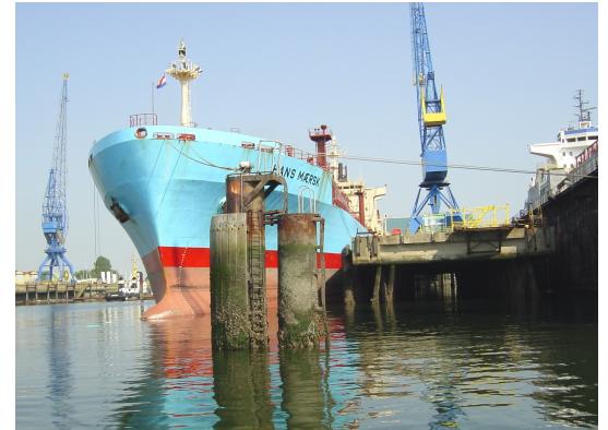
Afmeerpaal aangetast door corrosie, Scheldepoort Vlissingen.
