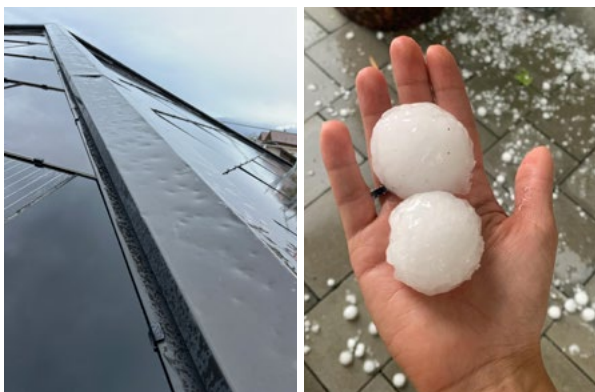
Hagelschäden in Einigen 2023
