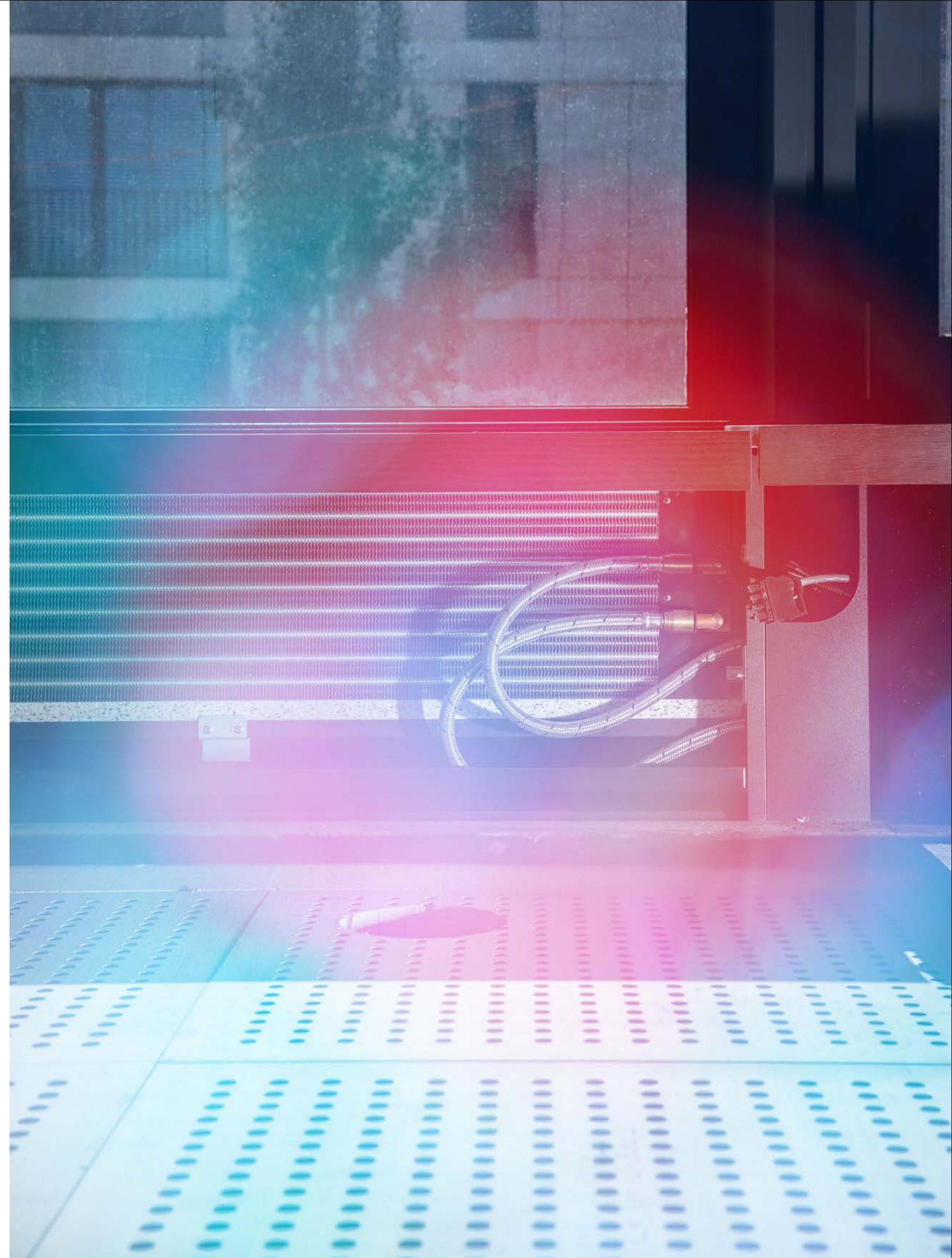
Über diese Klimageräte gelangt Frischluft in die Räume, wenn sie gebraucht wird – je nach Jahreszeit gekühlt oder erwärmt.
