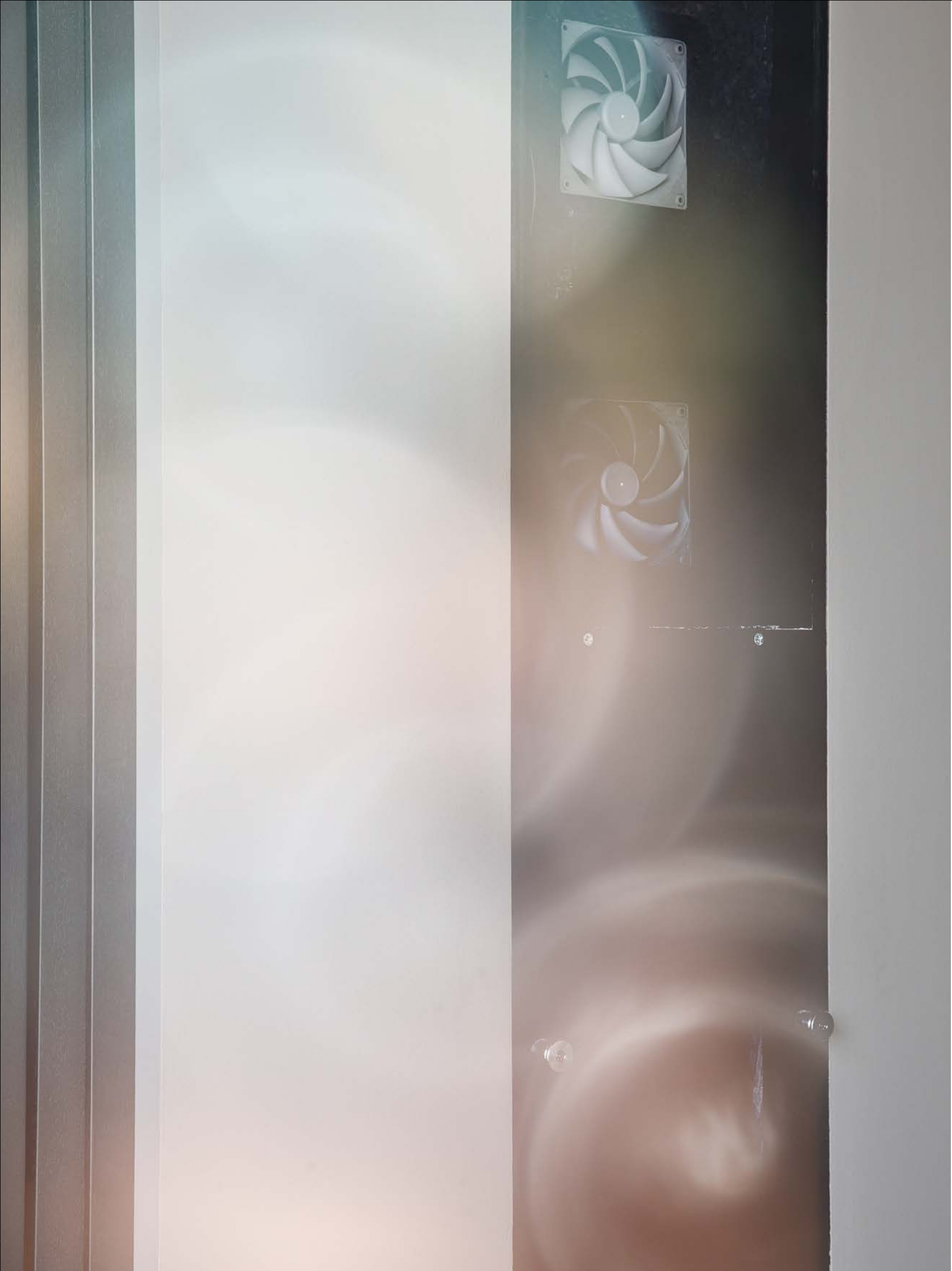
Riotherm-Verbundlüfter im Bürogebäude «ZERO» in Stuttgart-Möhringen, einem Vorzeigeprojekt der Internationalen Bauausstellung 2027.
