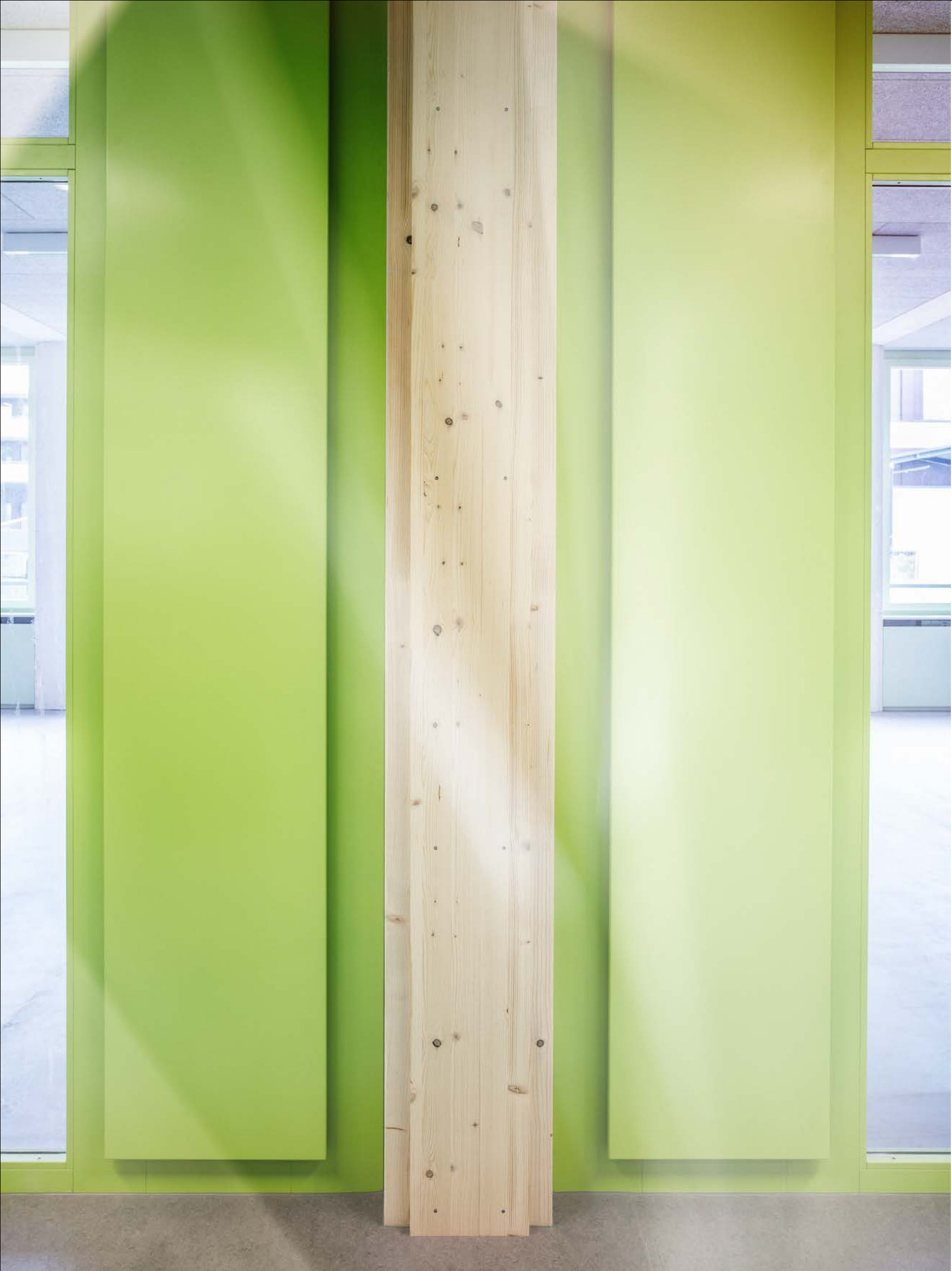
Kantonsschule Stadelhofen, Standort Dübendorf: Hinter den lindgrünen Abdeckungen neben den Türen arbeiten die Verbundlüfter beinahe geräuschlos.
