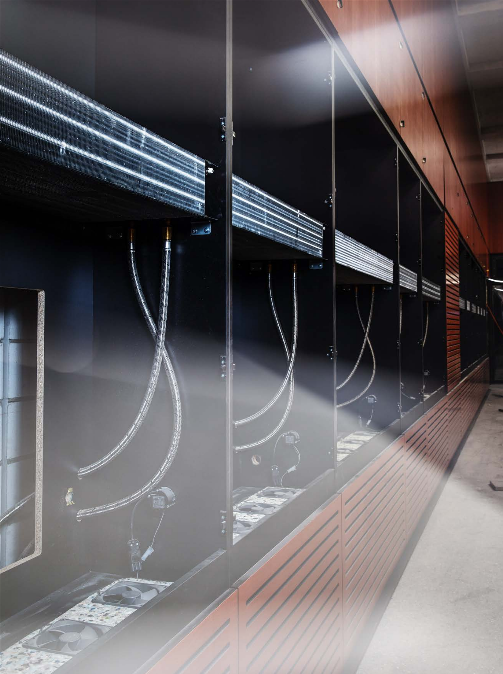
Raumklimageräte warten auf der Baustelle auf die Abdeckungen aus Holz und auf ihren Einsatz.
