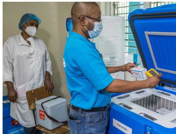
Un'unità frigorifero a energia solare installata a Port-au-Prince, Haiti, per lo stoccaggio di vaccini Moderna. Parte della catena del freddo equipaggiata dall'UNICEF, i contenitori frigo per il trasporto sul campo dei vaccini da somministrare ©UNICEF/UN0501729/Jean
