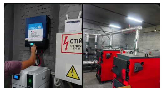
18 agosto 2025, Borodianka. I generatori installati dall'UNICEF nelle caldaie di Borodianka, per garantire che le scuole e gli asili rimangano al caldo durante le interruzioni di corrente. Per consentire ai bambini di continuare ad apprendere durante l'inverno, nonostante la guerra.
