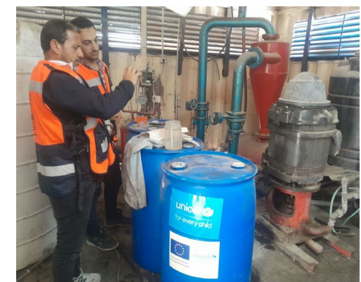
Aprile 2025, Striscia di Gaza. L'UNICEF ha fornito cloro e prodotti chimici per garantire la sicurezza e il funzionamento sostenibile dei pozzi e degli impianti di desalinizzazione nel nord e nel sud di Gaza. ©UNICEF-SoP/2025
