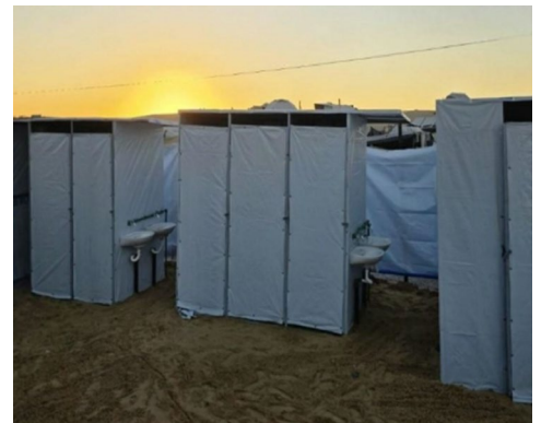
Striscia di Gaza, marzo 2026. Servizi igienico-sanitari mobili installati dall'UNICEF a Gaza, inclusivi di gabinetti e lavandini per il lavaggio delle mani, posizionati sia presso i rifugi per sfollati che Spazi temporanei per l'apprendimento (TLS)
