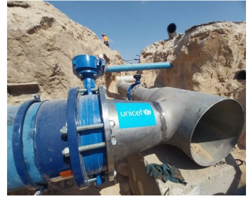
Striscia di Gaza, settembre 2025. L'acquedotto di Bani Said, che fornisce 15 milioni di litri di acqua potabile al giorno a 300.000 persone a Deir al Balah, Al Zuwayda e Al Bureij, ripristinato dall'UNICEF nell'area centrale della Striscia di Gaza ©UNICEF-SoP/2025
