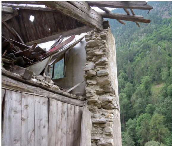
Figura 21. Sezione di muro in pietra danneggiato in Val Senales, con due strati esterni e un nucleo centrale composto da frammenti di pietra di piccole dimensioni. Foto: Lara Briz
