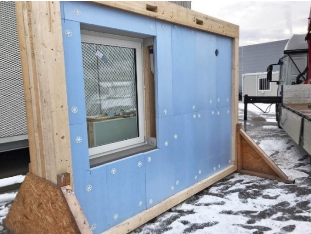
Figura 26. Modulo in legno prefabbricato del progetto Legnattivo, monitorato presso il parco Eurac. Il progetto, già descritto nella sezione 2.2, mira a sviluppare sistemi di facciata prefabbricata multifunzionale in legno per il retrofit di edifici residenziali, ottimizzando i tempi di cantiere. Fonte: https://www.marlegno.it/blog/marlegno/facciate-in-legno-per-il-risana-mento-energetico
