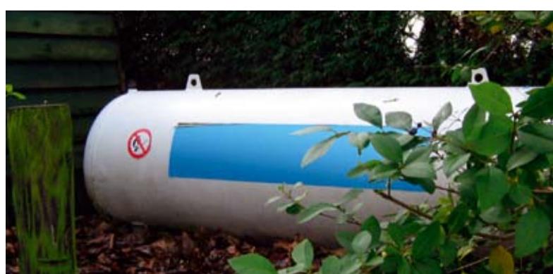
De tank staat te dicht op een schuur. Gelukkig is dit perceel groot genoeg om de tank te verplaatsen.
