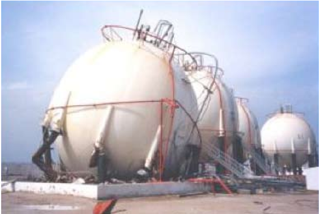
Figuur 2.1.1.4.1-6 Bezweken gassphere tijdens watertest door corrosie aan ondersteuningskolommen
