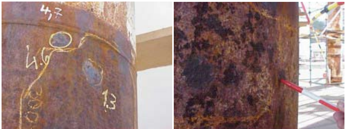
Figuur 2.1.1.4.1-8 corrosieplekken in ondersteuningskolommen gasspheres
