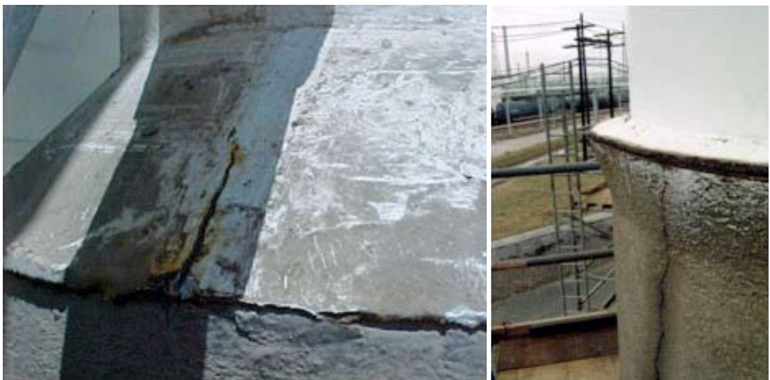
Figuur 2.1.1.4.1-7 Corrosieveroorzakende 'waterdeflector'
