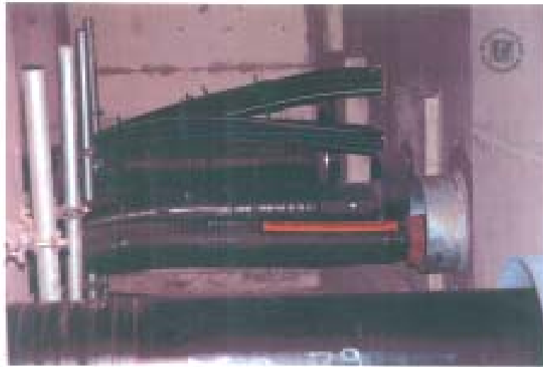
Foto 5-7 Doorvoering in het eindgebouw Zuid (binnenzijde) van de leidingen voor achtereenvolgens kerosine, ethyleenoxide (met rode band) en waterstof, onmiddellijk na het incident (ref. 1.r)
