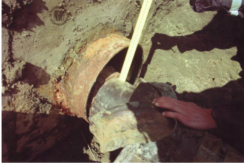
Foto 5-6 Doorvoering in het eindgebouw Zuid (buitenzijde) van de H2-leiding onmiddellijk na het incident (ref. 1.r)
