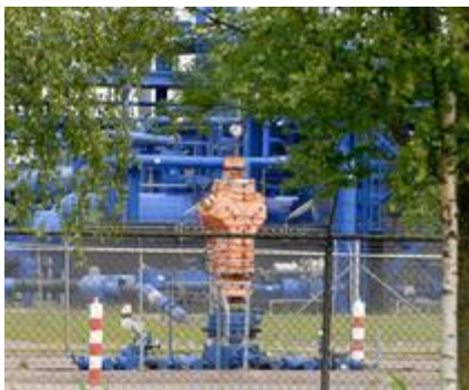
Installatie voor ondergrondse opslag van CO 2 te Barendrecht. 42
