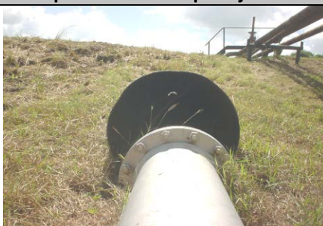
Lekke seal in pijpdoorvoering door putdijk.
