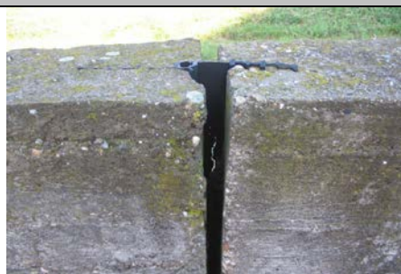
Lekke dilatatievoeg in betonnen putdijk.
