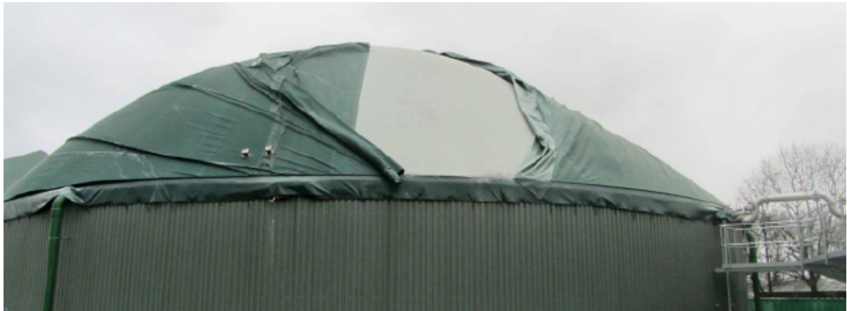
Voorbeeld van een gescheurde gasopslag
