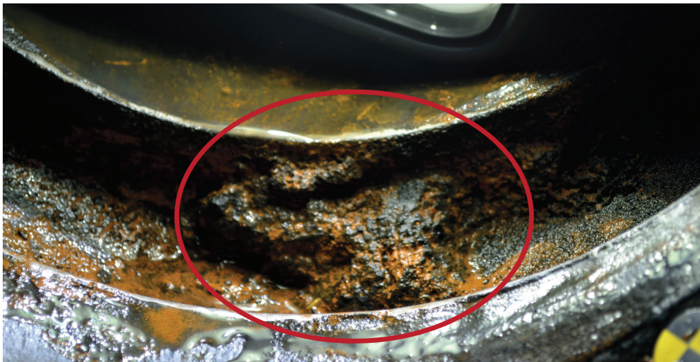
Figuur 12: Foto van de vervuiling in de slave-afsluiter. Noot: Rode ovaal geeft locatie van een deel van de vervuiling aan. (Bron: Inspectie SZW). 200
