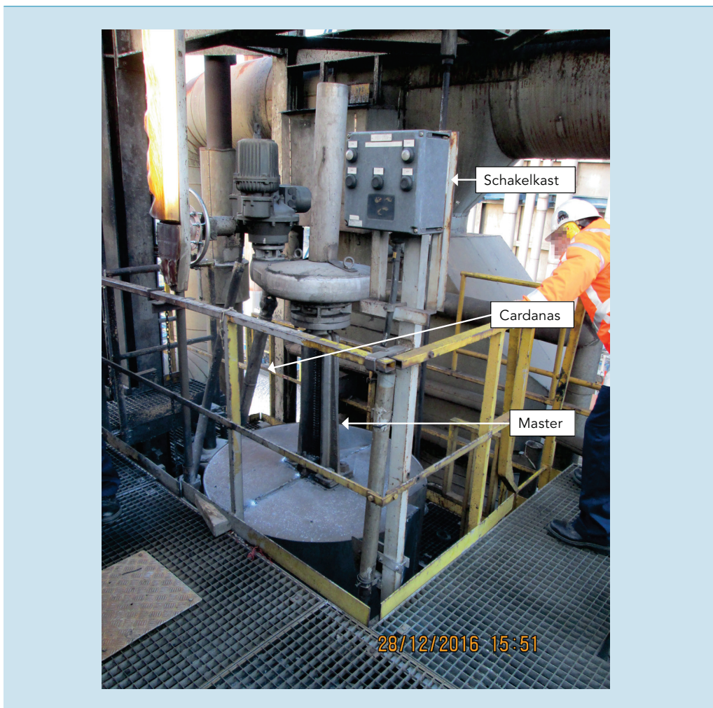
Figuur 11: Masterafsluiter met bedieningspaneel (Bron: Inspectie SZW)
