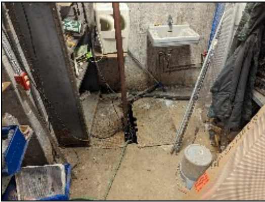
11. BLDG-3, sump pump-1
