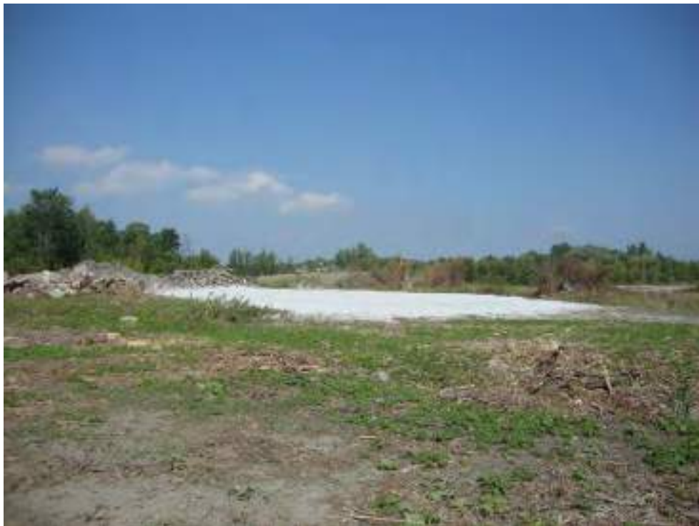
Photo 9 : Zone A - Vue de l'aire de traitement in-situ A7 suite à l'épandage de chaux.
