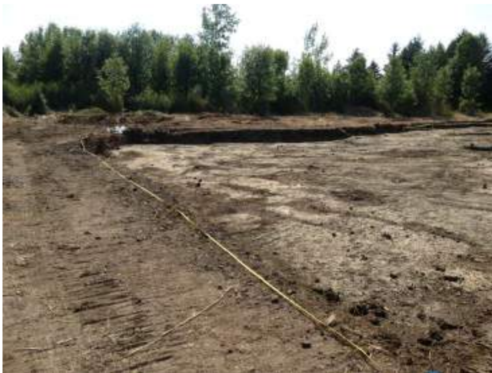
Photo 25 : Zone C - Vue vers le sud-ouest des excavations C3, C4 et C5.
