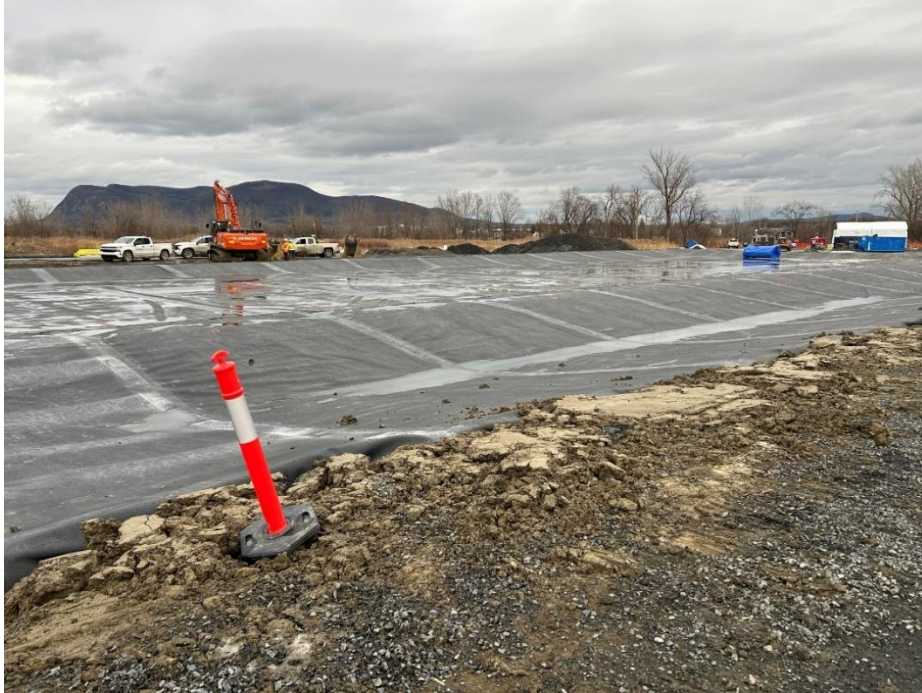
Figure 4 Aire de traitement étanchéisée
