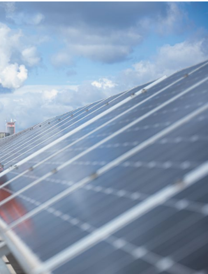
Solární panely na střeše výrobního závodu Škoda Group v Plzni
