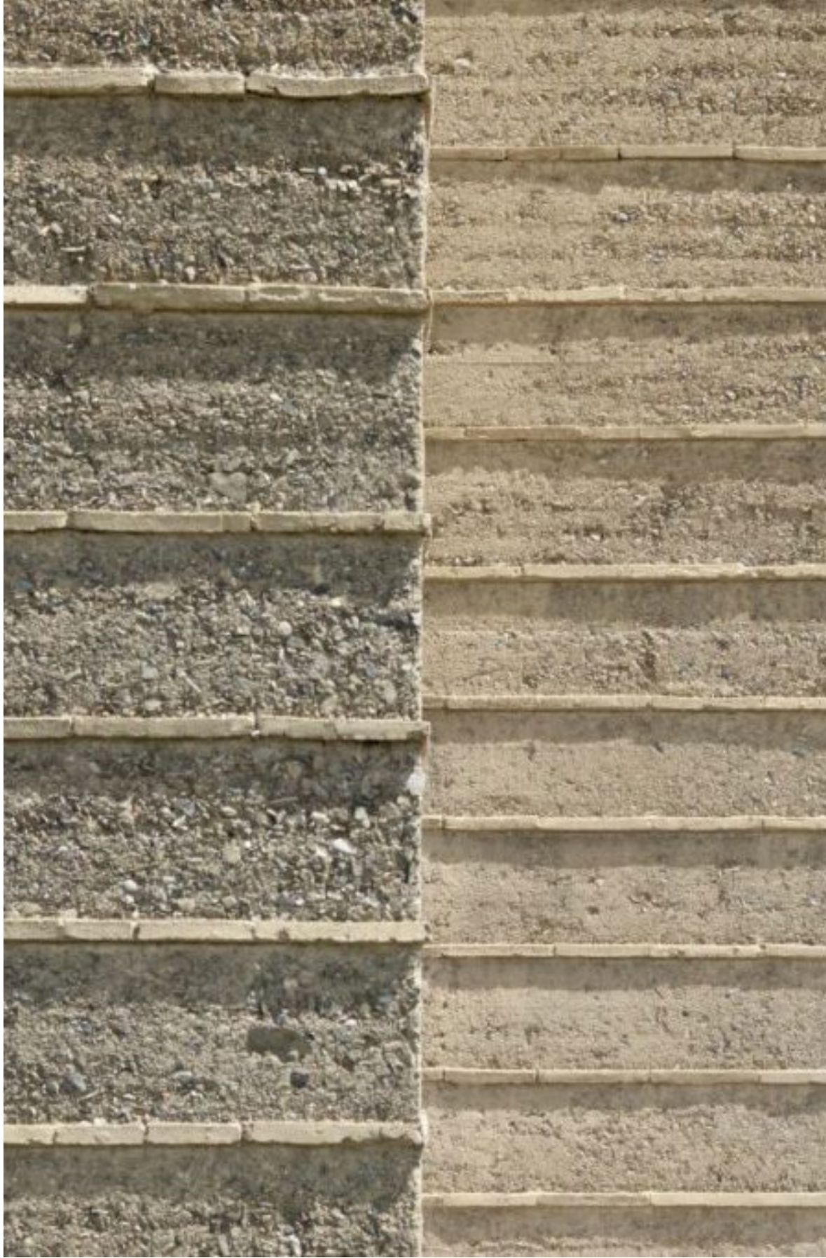
House Rauch, Martin Rauch, Schlins (Austria)
