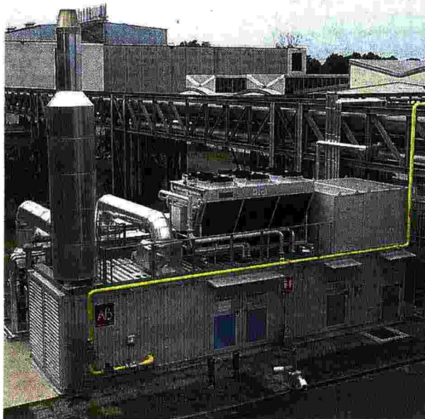
La soluzione Il cogeneratore Ecomax di Ab da 1 MW installato a Pavia
