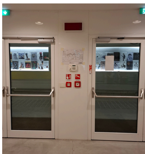
Posizione di allarme anti incendio e piano di evacuazione
