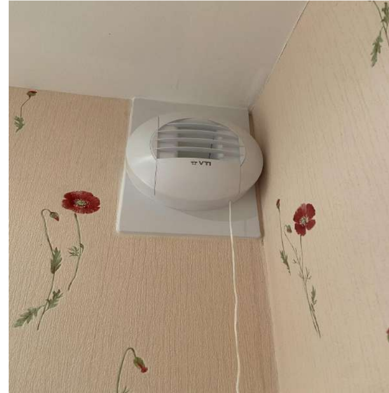
Installation de la bouche cuisine avec sa cordelette de grand débit
