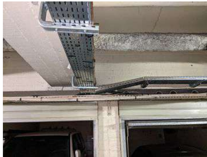
Chemins de câbles
