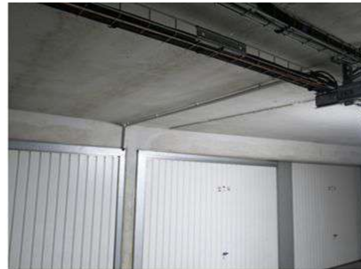
Chemins de câbles
