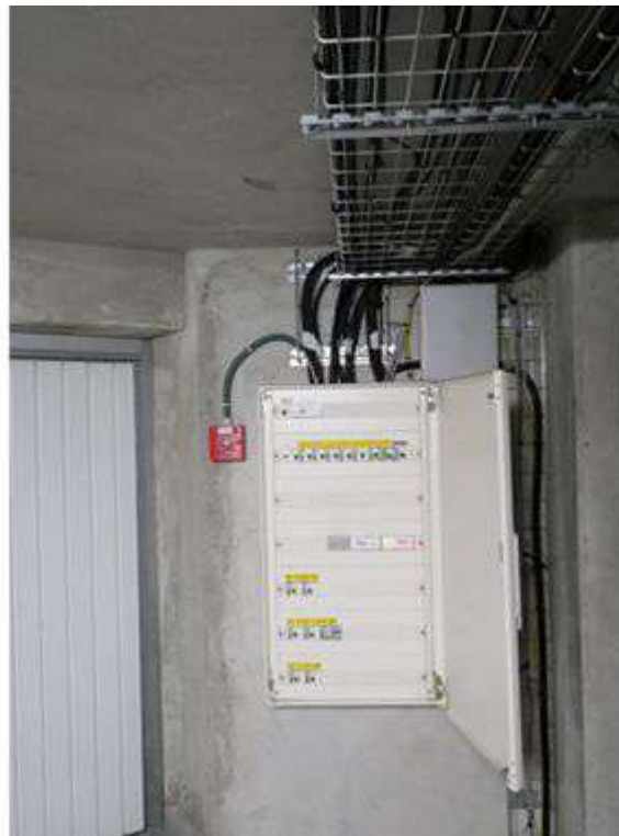
Compteur électrique intermédiaire
