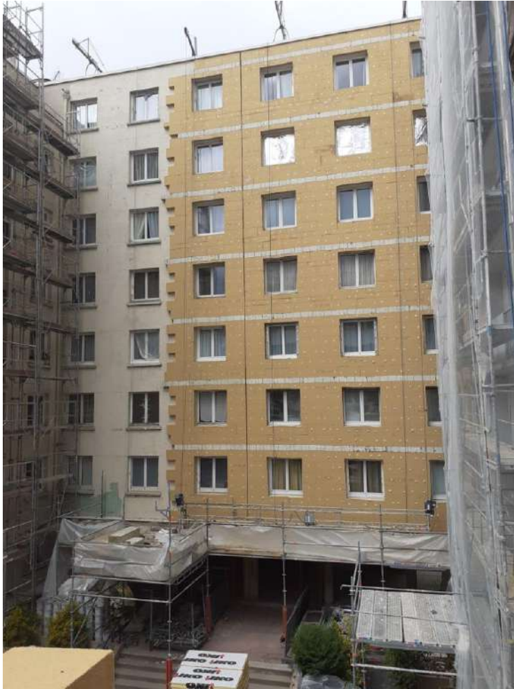
Isolation en laine de bois
