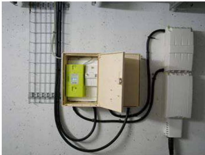
Point de livraison dédié à la recharge
