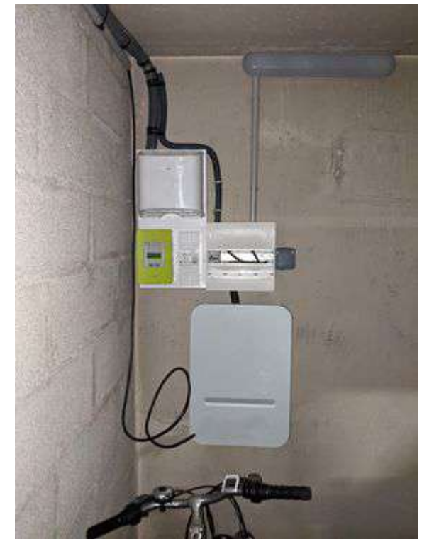
Compteurs et équipements dans un garage
