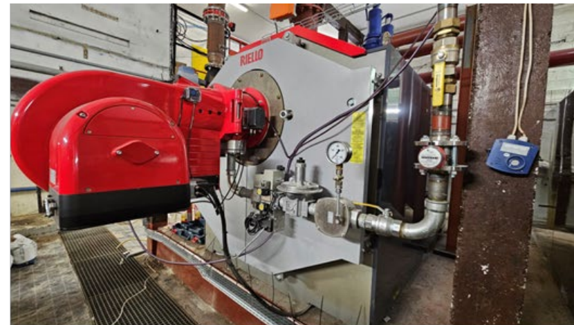
Chaudières à condensation
