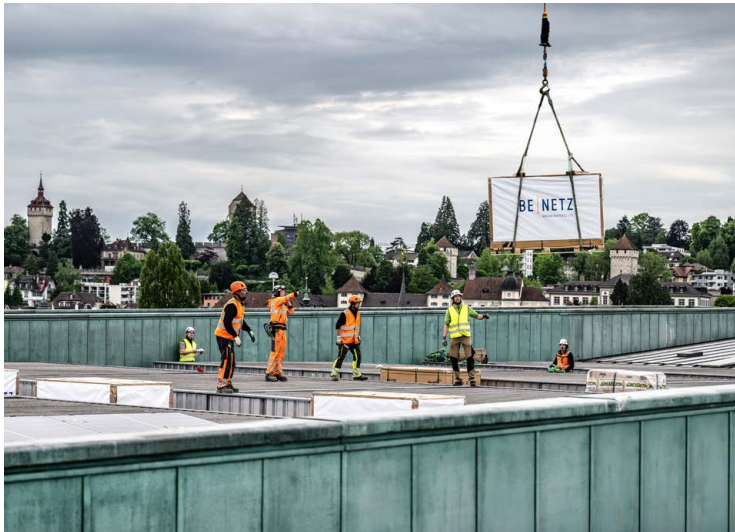
Anlieferung der Module per Flug auf das Dach des KKL Luzern zum Montagebeginn der Photovoltaikanlage
