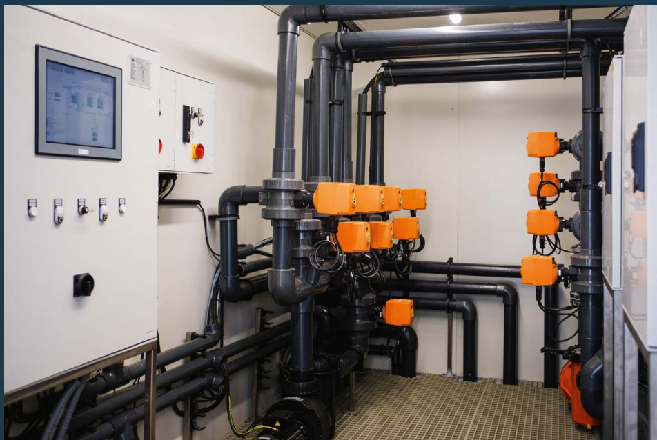
QUADRO DI CONTROLLO POMPE CON TOUCHSCREEN
