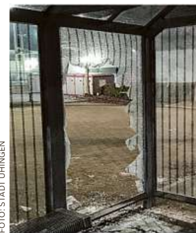
Zertrümmerte Glasscheibe am Uhinger Bahnhof.
